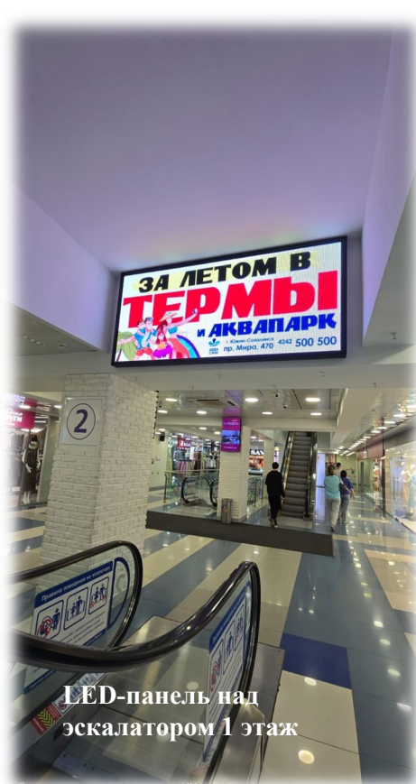
LED-панель над эскалатором 1 этаж
